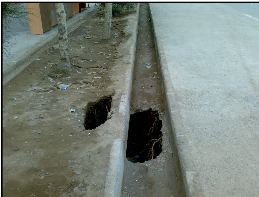
شکل ۱: نشست زمین در قنات‌های متروکه شهر سبزوار
