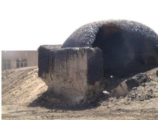
شکل ۱۴: تخریب دیوار شمالی اتاق در اثر ضربات ماسه‌ها
